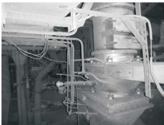
Rys. 4. Widok zabudowy rury transportującej paliwo z podajnika celkowego oraz śluzy odcinającej (fotografia autora)
