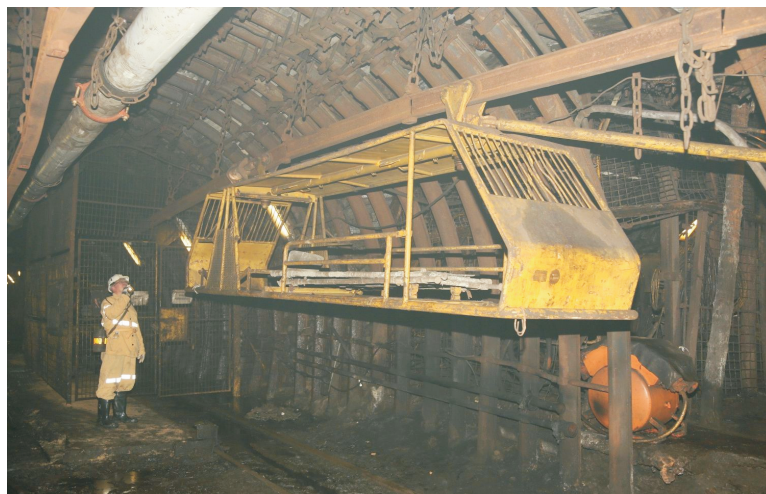
Rys. 2. Platforma sanitarna kolejki podwieszanej
