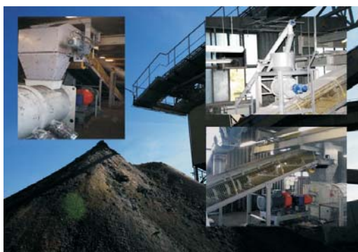
Fot. 10. Instalacja do produkcji granulatów w ZG Sobieski w Jaworznie (opracowanie własne)
