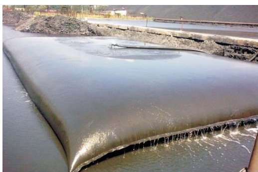
Fot. 13. Tuba odwadniająca z geosyntetyków napelniana osadem w ZG Janina (opracowanie własne)
